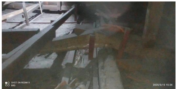
Foto 4 : Penyangga atap yang patah
