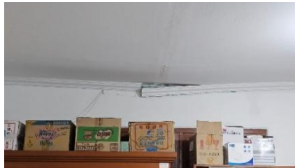
Foto 2 : Plafon yang turun
